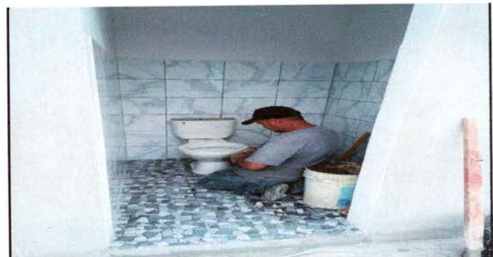
Foto: 6 Servicios Sanitarios y sus Accesorios
