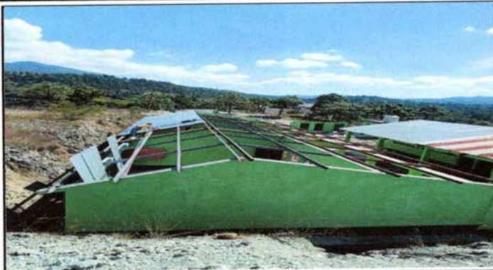
Foto: 1 Sustrucción de Lámina
