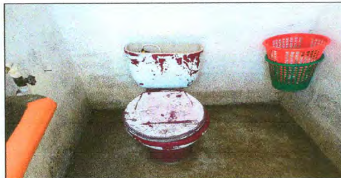
Foto: 6 Servicios Sanitarios y sus Accesorios
