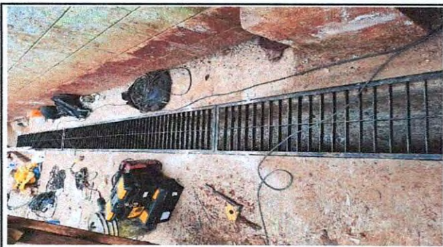
Foto 12: Parrilla para protección de cuneta
