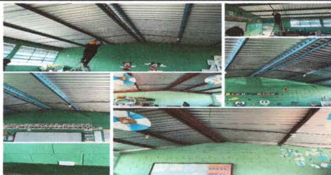
Foto 1: Sustitución de lamparas tipo LED
