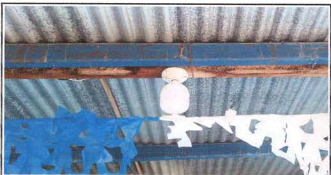
Foto 3: Sustrucción de cable y foco
