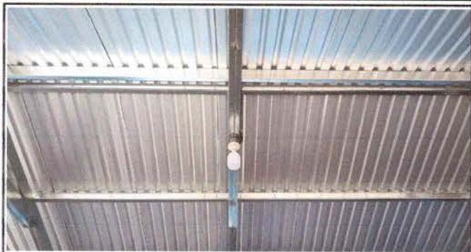
Foto1: Sustrucción de cable y foco
