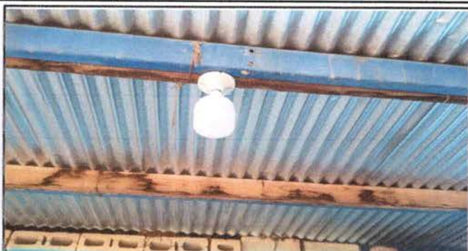
Foto 2: Sustrucción de cable y foco
