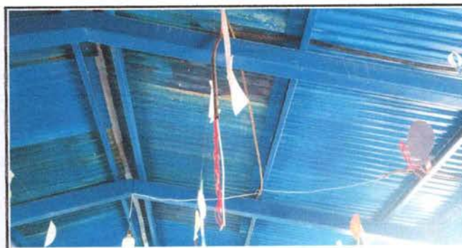
Foto 4: Sustrucción de cable
