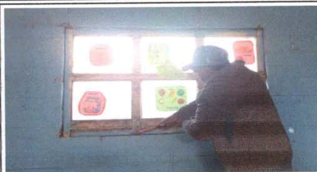
Foto 2: Sustitución de ventana de madera a metal
