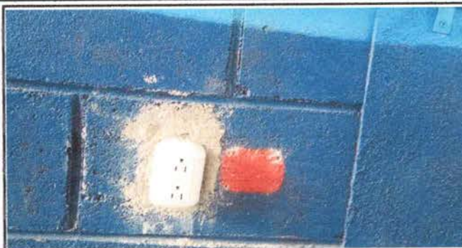
Foto 2: Sustrucción de toma corrientes
