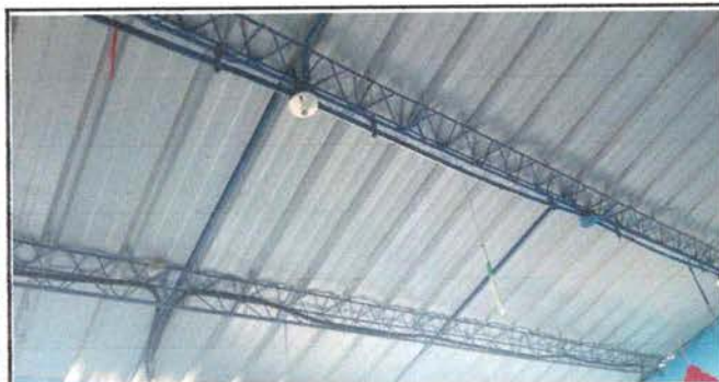
Foto 3: Sustrucción de cable
