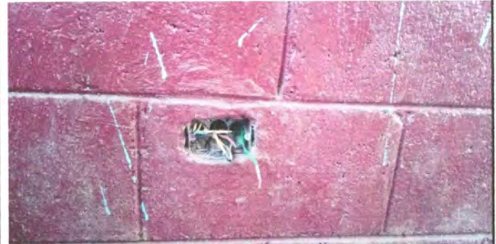
Foto 4: Sustrucción del sistema eléctrico
