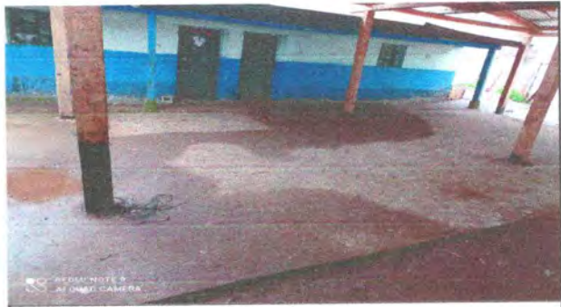
Foto 4: Susticion de plancha de concreto de patio
