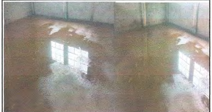
FOTO 8: Sustrucción de torta de cemento
