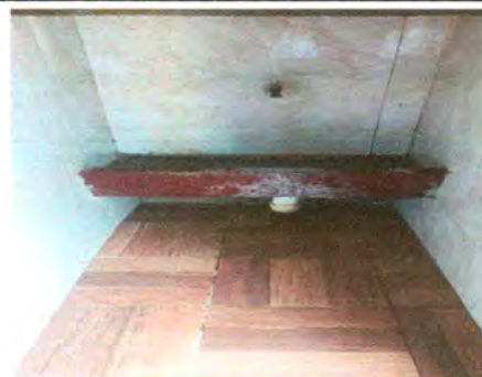
Foto 6 servicios sanitario y sus accesorios
