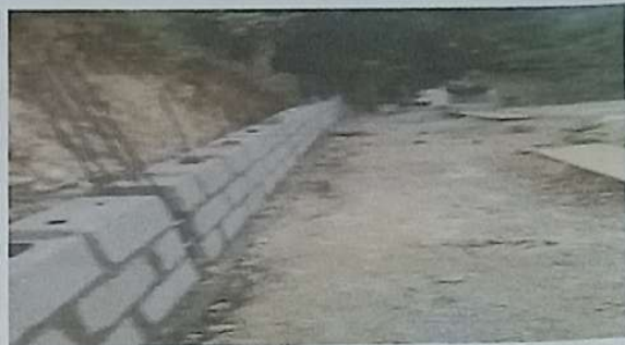
Foto 2: CERCO O MURO PERIMETRAL EN MALAS CONDICIONES
