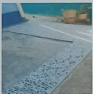
Foto 3: PISO CON GRIETAS Y LEVANTADO
