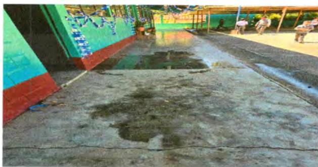
Foto 3: PISO CON GRIETAS Y LEVANTADO
