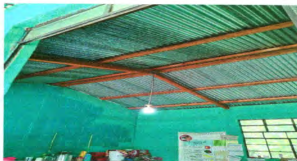
Foto 6: SOPORTE DE MADERA Y LÁMINA EN MALESTADO, VENTANAS EN MAL ESTADO
