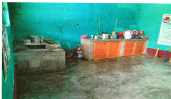
Foto 4: PLANCHA EN MAL ESTADO Y NO APTA PARA COCINAR LOS ALIMENTOS DE LOS ESTUDIANTES , MEJORAMIENTO DE MUEBLE DE CONCRETO
