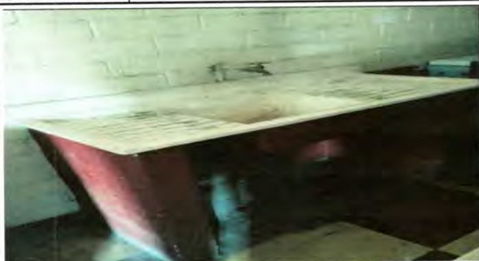
Foto 7: Sustrucción de lavatrastos
