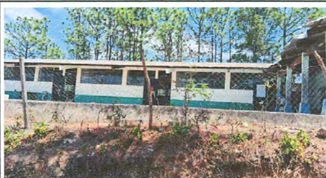
Foto 1: AREA PERIMETRAL DAÑADA
