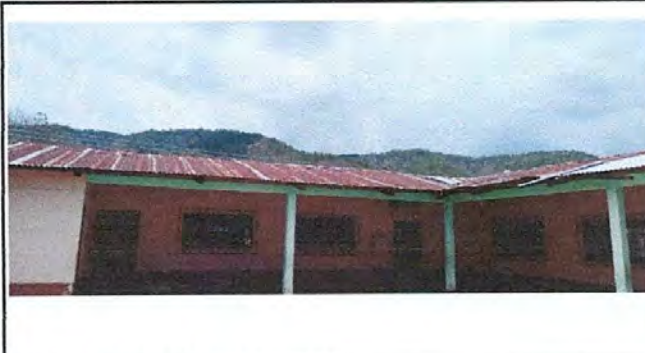
Foto 3: Lámina ha sufrido de corrosión
