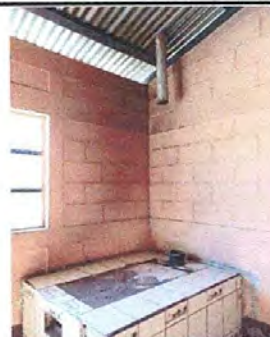
Foto 6: Chimenea ha sufrido de corrosión
