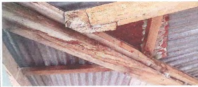
Foto 2: Costaneras en mal estado
