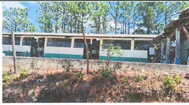
FOTO 2: CIRCULACION MALAS CONDICIONES
