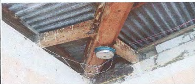
Foto 1: Costaneras en mal estado
