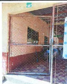
Foto 5: Portón en malas condiciones
