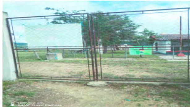
Foto 4: PORTON EN MALAS CONDICIONES
