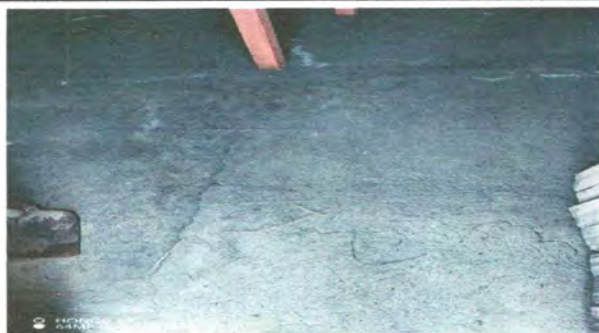
Foto 5: TORTA DE CONCRETO DAÑADA
