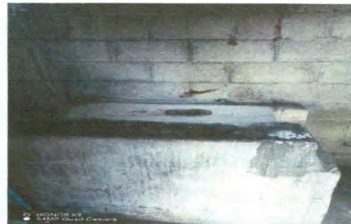
FOTO 6: ESTUFA RURAL EN MALAS CONDICIONES
