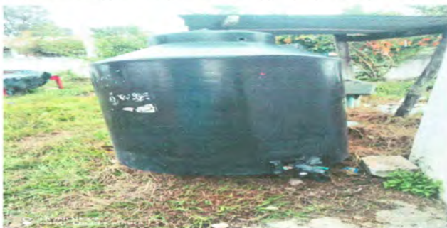
FOTO 5: DEPOSITO DE AGUA DAÑADO
