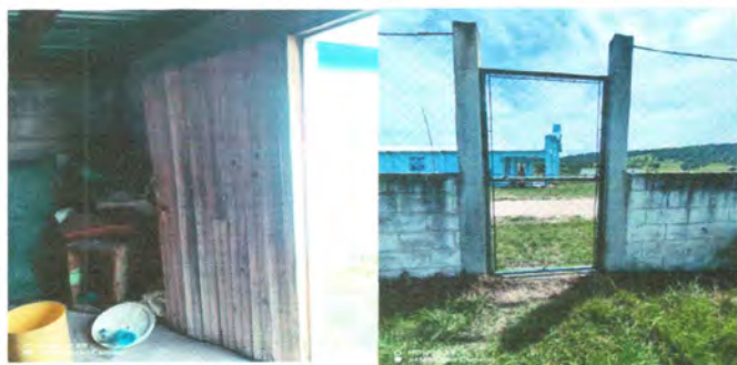
Foto 3: PUERTAS EN MALAS CONDICIONES
