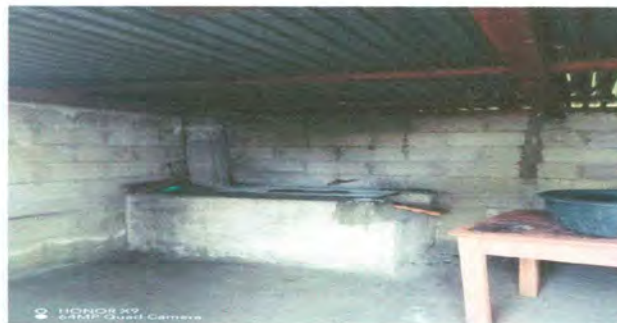
FOTO 2. SOPORTE DE MADERA DAÑADO
