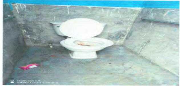
FOTO 2. BAÑOS EN MALAS CONDICIONES
