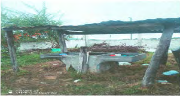
FOTO 1. PILA EN MALAS CONDICIONES
