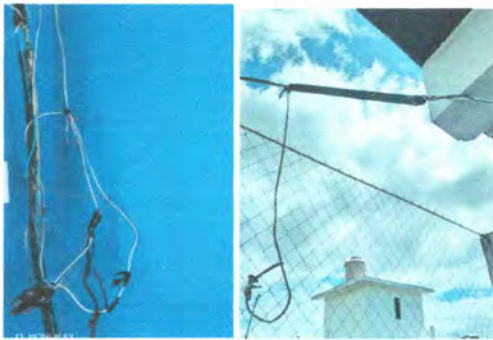
FOTO 3: CABLEADO ELECTRICO EN MALA CONDICION
