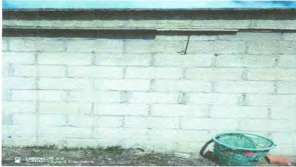
FOTO 1. MURO SIN AREGLAR
