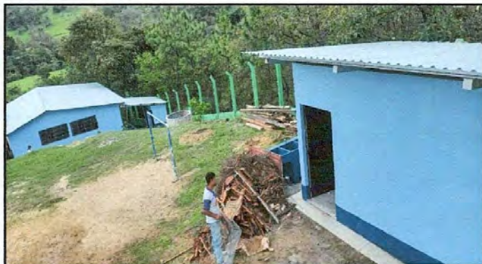
Foto 1: Sustrucción de lámina de los baños, de la cocina, de dos aulas y la dirección.
