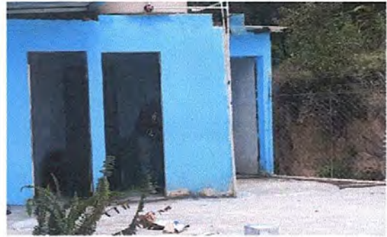
Foto 8. SERVICIOS SANITARIOS Y ACCESORIOS
