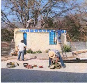
Foto 1: SUSTITUCIÓN DE LAMINA (MAL ESTADO)
