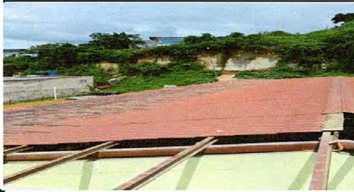
Foto1: costaneras oxidadas y lámina vieja con agujeros
