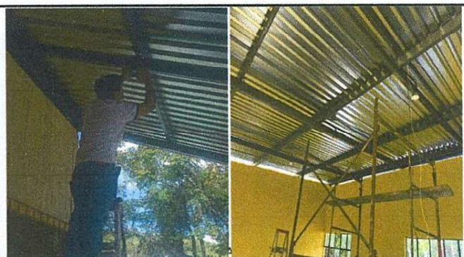
Foto 5: Electricidad en aulas, corredor y bodega
