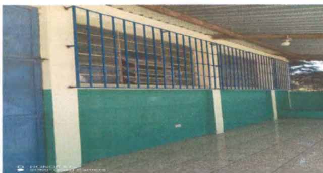
Foto: 5 BALCONES VENTANAS QUE NECESITAN PROTECCIÓN
