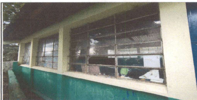
Foto: 5 BALCONES VENTANAS QUE NECESITAN PROTECCIÓN
