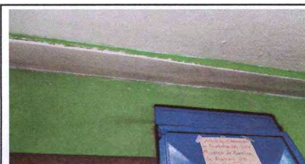
Foto 5: Repello y cernido de grieta en cocina.
