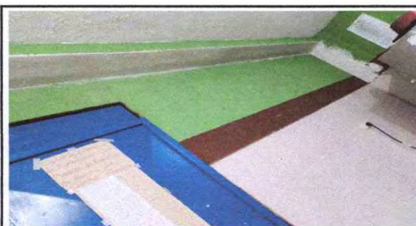
Foto 6: Repello y cernido de grieta en cocina.
