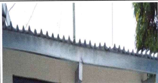
Laminas del techo de la escuela.
