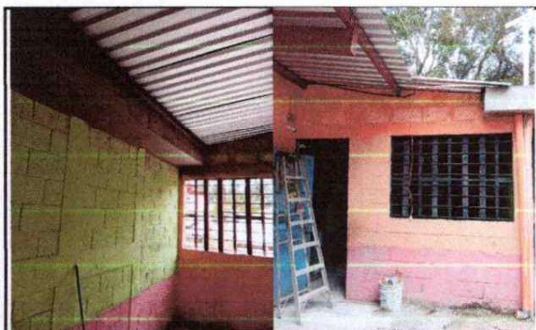
FOTO 3: CANAL DE CONCRETO DENTRO DE AULA PEQUEÑA, SUSTITUCIÓN DE BARANDAL POR BLOCK EN LA PARTE SUPERIOR DE AULA PEQUEÑA.
