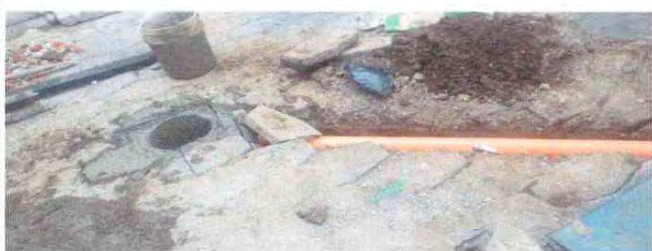
Foto 5: drenaje de pila
