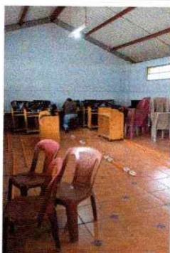
Foto 15: Agregado de acametida eléctrica en salón de computación para conexión de 20 equipos de computación.
