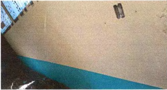
Foto 1: CERNIDO EN MURO Y PINTURA
