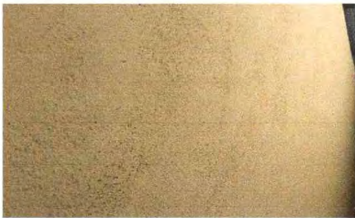
Foto 3: CERNIDO EN MURO Y PINTURA
