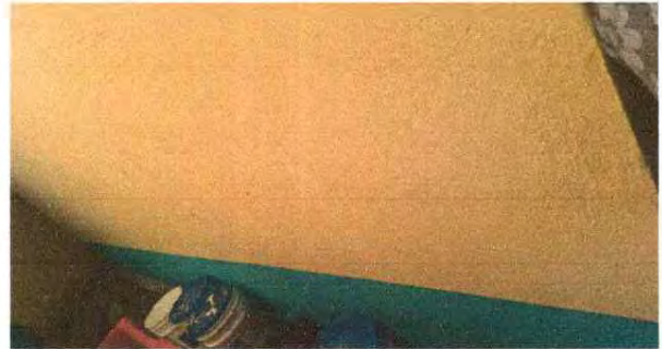
Foto 2: CERNIDO EN MURO Y PINTURA
