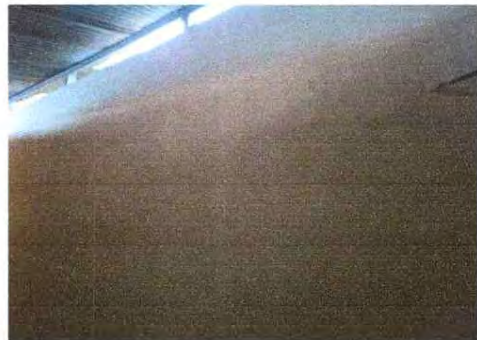
Foto 4: CERNIDO EN MURO Y PINTURA
