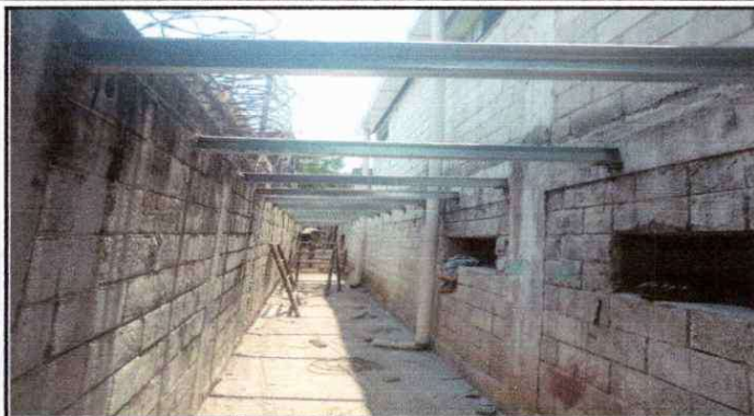
Cubierta DE LÁMINA (28.00M2) lamina Troquelada , para bodega de Cocina, sanitarios y aula
