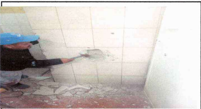
SERVICIOS SANITARIOS Y SUS ACCESORIOS ( ampliación ) por la cantidad de alumnos los sanitarios no se daban abasto
