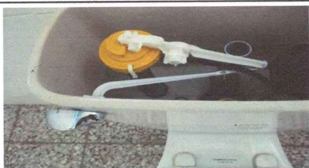
Foto 5: ACCESORIOS SANITARIOS Y FOSA SÉPTICA
