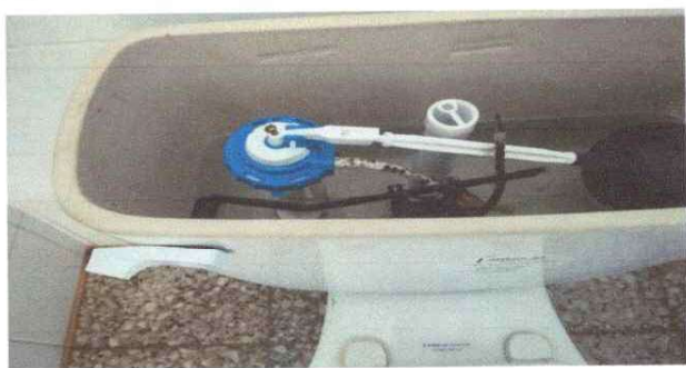
Foto 5: ACCESORIOS SANITARIOS Y FOSA SÉPTICA
