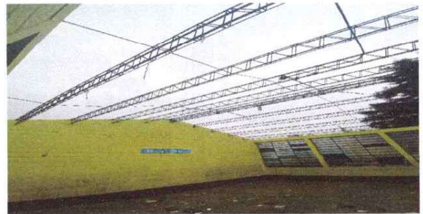
FOTO 4: Salones de clase sin techo, para sustituir duralita.
