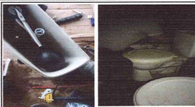
Foto 2: Sanitarios y accesorios
