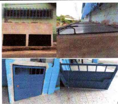
Foto 9: Puertas con pasador y candado para contenedor de basura sobre la 1 calle zona 2 y sus 2 tapaderas de metal, 1 puerta de metal con chapa para el área de la bomba de agua
