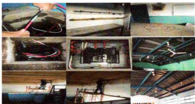
Foto 3: trabajo de cableado y ducto para bombillas, apagadores, cables que se encontraban al aire o expuestos
