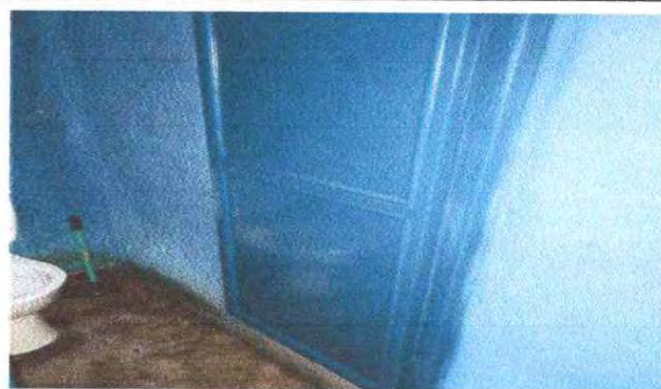
Foto 4: pintura en puertas
