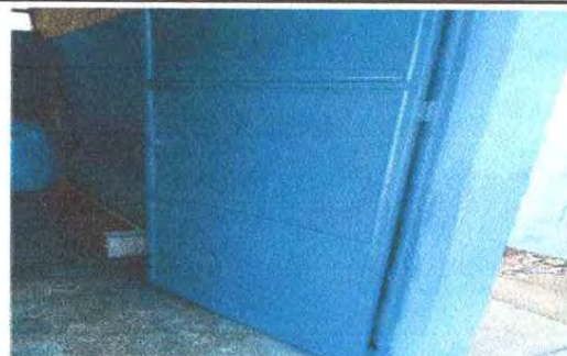
Foto 6: pintura en puertas
