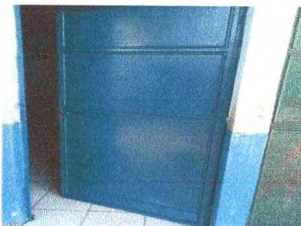
Foto 2: pintura en puertas
