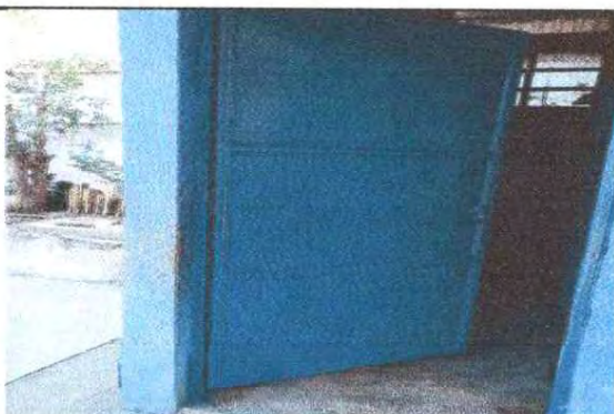
Foto 3 pintura en puertas
