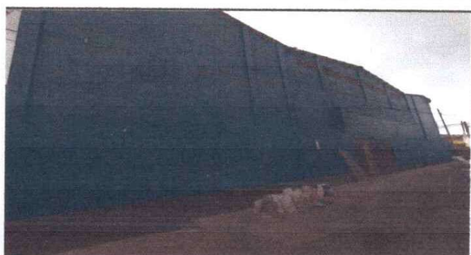
Foto 4: Parte frontal del establecimiento pintado
