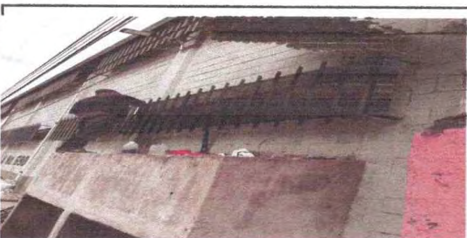
Foto 5: Mantenimiento , balcones del area exterior calle principal
