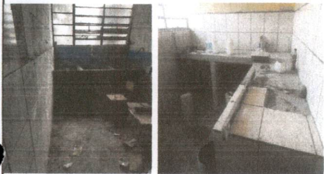
Foto1: Proceso área cocina, piso, gabinetes, puerta y pasa manos.
