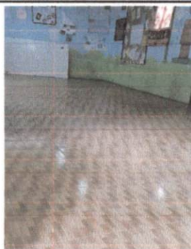
Foto 9: Piso aula No 2 modulo 3 planta baja.
