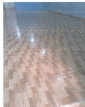
Foto 4: Piso aula No 2 modulo 1 planta baja.
