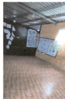
Foto 8: Piso aula No 1 modulo 3 planta baja.
