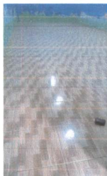
Foto 3: Piso aula No 1 modulo 1 planta baja.
