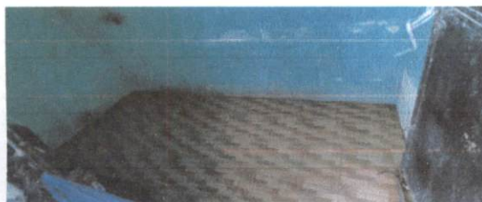
Foto 15: Piso, bodegas, direccion modulo area administrativa.
