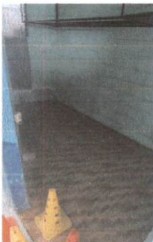
Foto 13: Piso bodega de alimentos.
