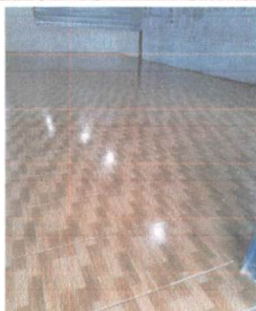
Foto 5: Piso aula No 3 modulo 1 planta baja.
