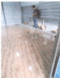
Foto 7: Piso aula No 2 modulo 1 planta alta.
