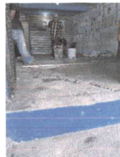
Foto 6: Piso aula No 1 modulo 1 planta alta.
