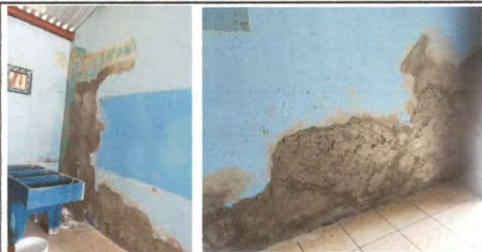
Foto 14: Áreas resanadas que se habían desprendido por filtraciones de agua.
