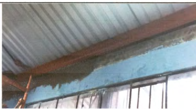
Foto 4: Sellada de abertura en el área de cocina.
