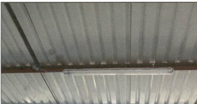
Foto 5: Mejoramiento en sistema eléctrico
