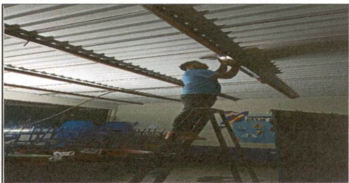
Foto 6: Mejoramiento en sistema eléctrico
