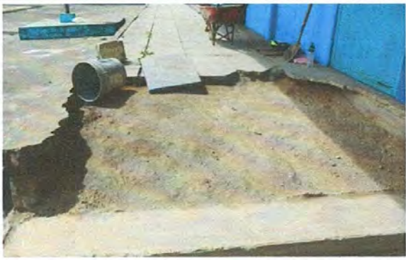
CORREDOR DESTRUIDO EN SU PARTE FINAL MODULO DE LA CANCHA
