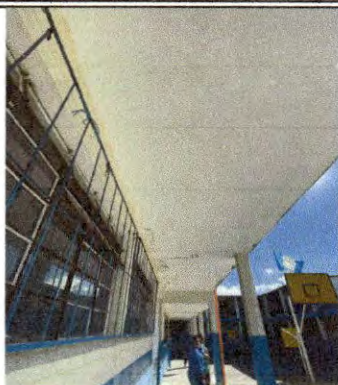
Foto 1: Módulo A, losa interna en mal estado
