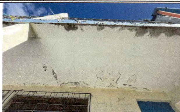
Foto 2: Módulo A, losa interior en mal estado
