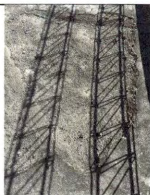
Foto 9: Módulo A, losa en mal estado
