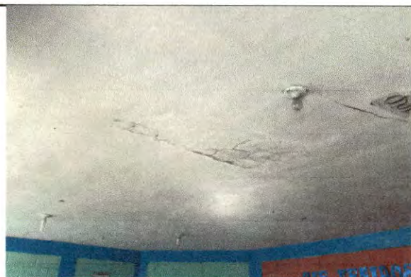
Foto 3: Módulo B, losa en mal estado
