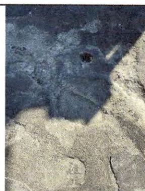
Foto 6: Módulo A, losa exterior en mal estado
