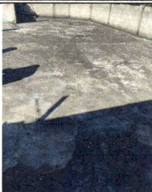
Foto 7: Módulo B, losa exterior en mal estado
