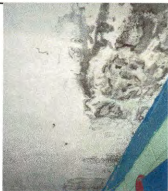
Foto 5: Módulo A, losa en mal estado
