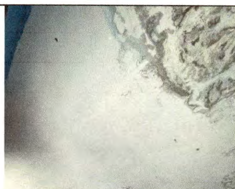
Foto 4: Módulo B, losa interior con humedad
