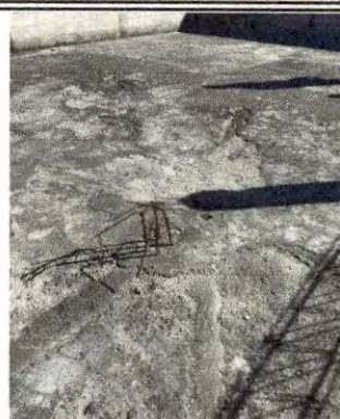
Foto 8: Módulo A, losa en mal estado
