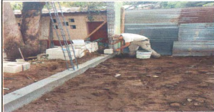
Foto 6: solera de humedad.
