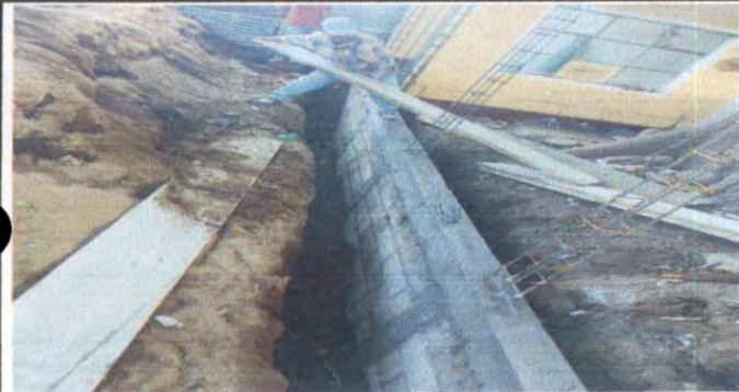
Foto 5: solera de humedad
