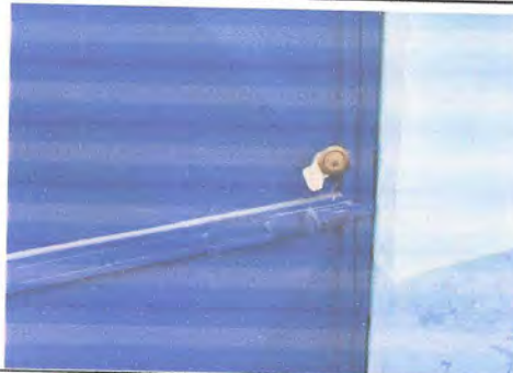
Foto 8: Modulo 2, Chapas en mal estado
