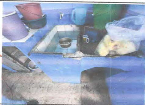
Foto 11: Modulo 1, pila en mal estado
