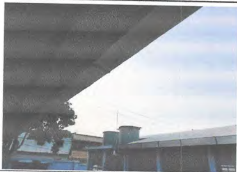
Foto 9: Modilo 1 y 2, canales en mal estado
