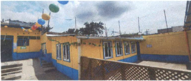
Foto: 1 Ventanas por arreglar
