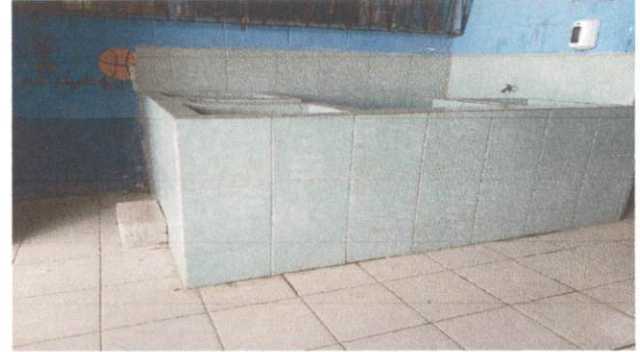
Foto 2: PILETA DE 3 LAVADEROS
